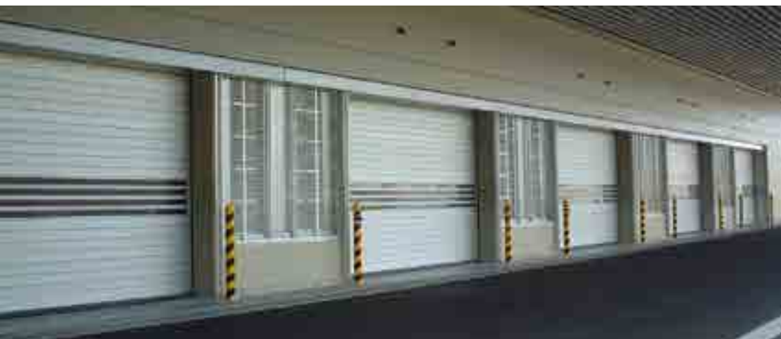
飲料品工場の出荷口への設置例
