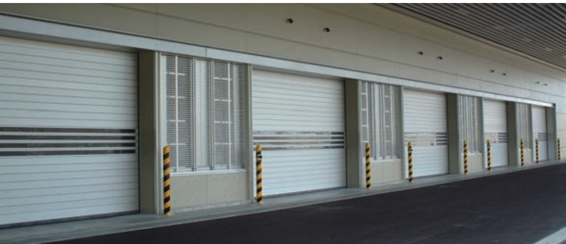
飲料品工場の出荷口への設置例
