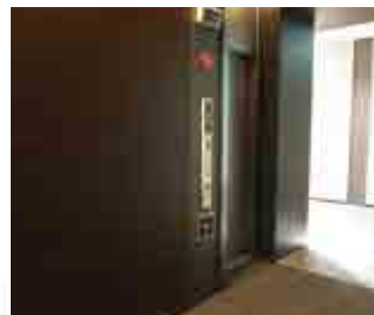
エレベーターの呼び出し連動
